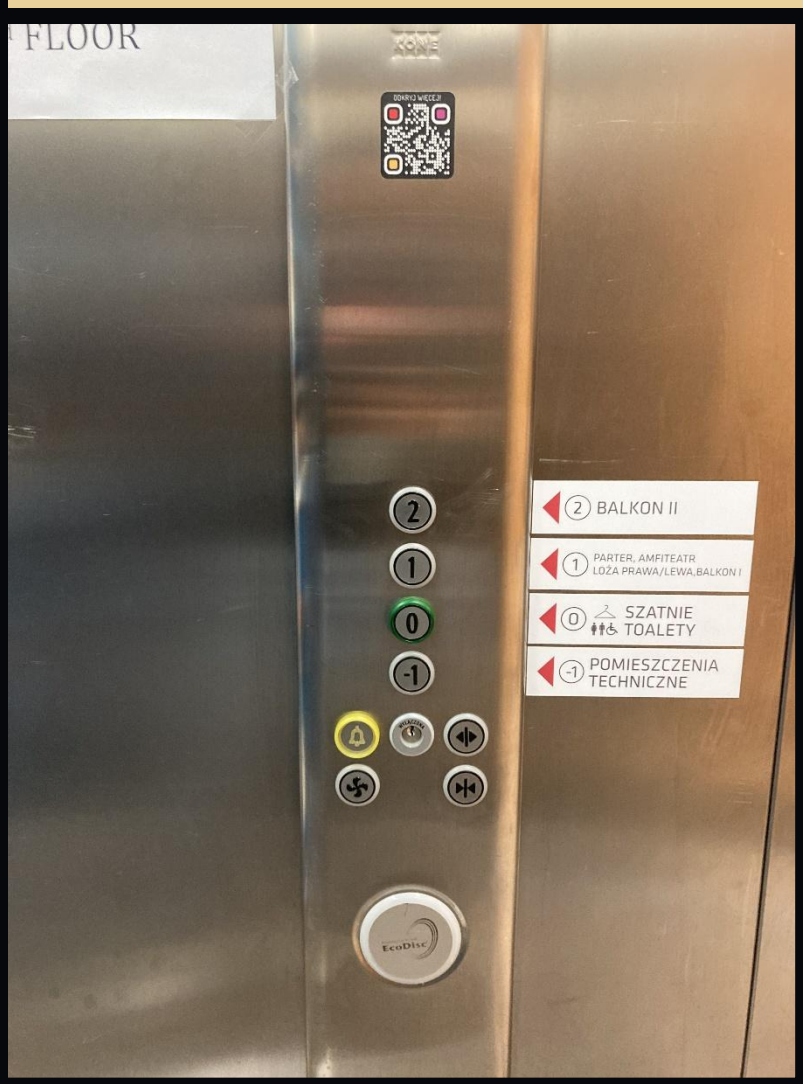
Zdjęcie 7. Opisy poziomów w windzie. Fot. Marta Otrębska.
